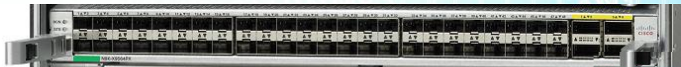
Switch con huecos vacíos para módulo enchufables
